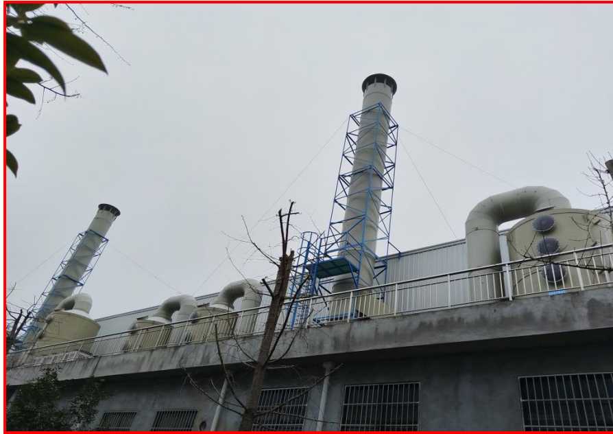
5#厂房表面处理车间电镀生产线废气处理系统
