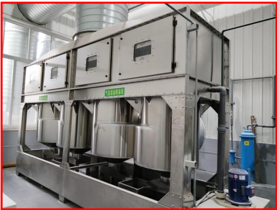
气旋混动除尘设施
