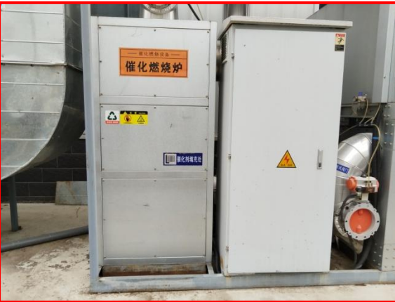
催化燃烧炉（喷漆工序）
