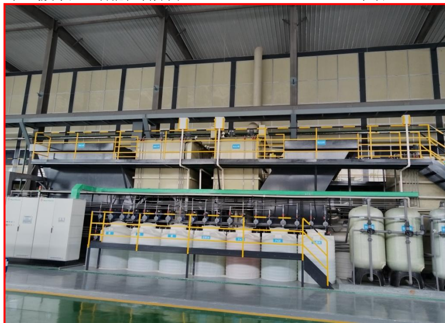
5#厂房表面处理车间废水处理系统
