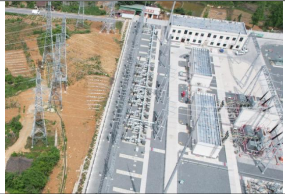
330kV牧马河变
